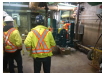
Pompes d'alimentation à filtre-pressé à bande série HPE pour le transfert des boues primaires
